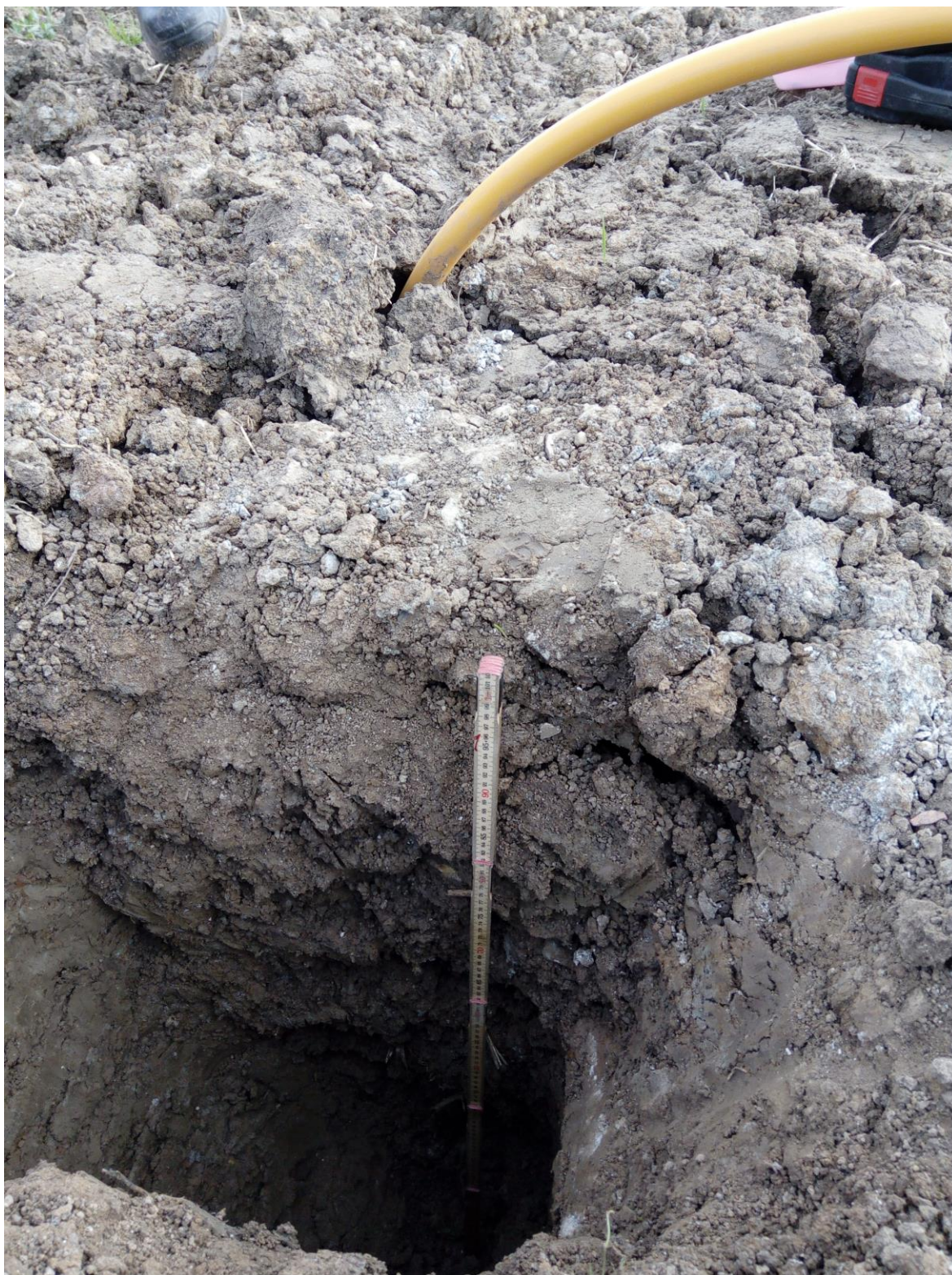
Figur 2. En temperaturgivare grävdes ned på 1 meters djup. På bilden syns anslutningsröret där precisionsmanometern kommer att anslutas.
